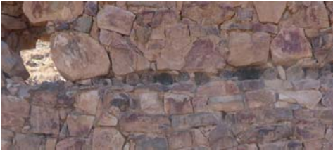
Figura 11. Troncos en el muro norte que sostuvieron el 2do nivel en la Estructura B de la Kancha Inca
